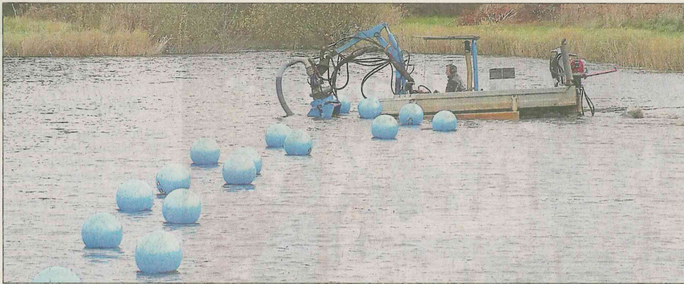
Bei der Entschlammung der Lohneteiche setzte die ausführende Firma aus Bad Hersfeld ein mit einer Ausleger-Fräse ausgestattetes Amphibien-Fahrzeug ein. • Foto: UD Umweltdienste
